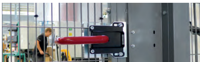
Dørlås set inde fra en robotcelle. Man må aldrig kunne blive lukket inde i en maskine. Denne dørlås kan ikke låses eller blokeres
