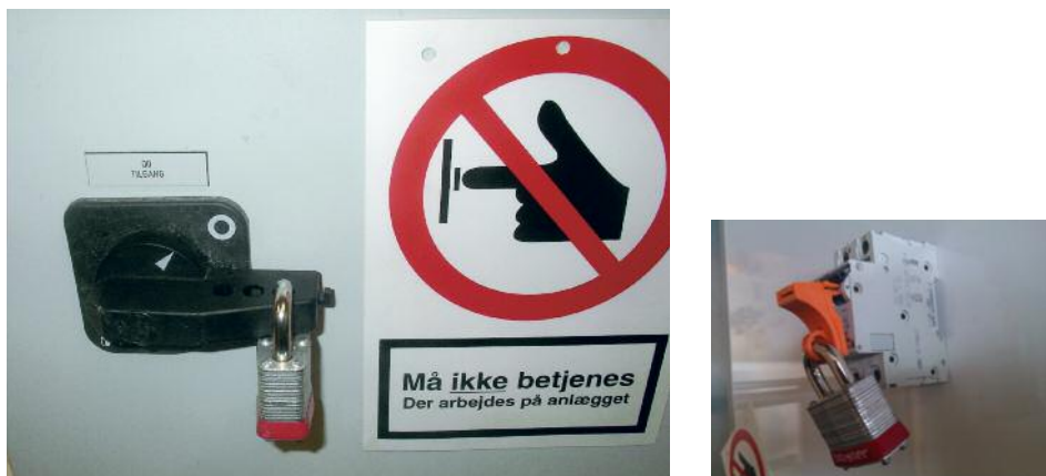
Afbryderhåndtag med én hængelås og plads til flere. Automatsikring med monteret hængelås.
