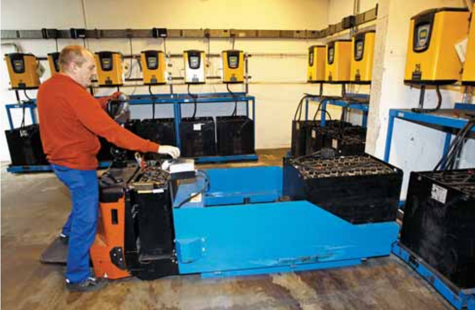
Indretning af ladestation
