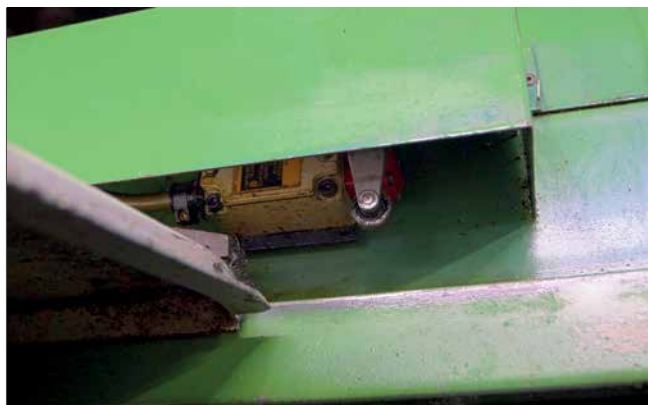
Typisk ældre sikkerhedsafbryder på skydelågen.
