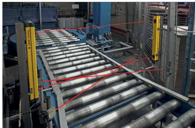
Lysgitter med forbikobler ved udkørsel fra pakkerobot.
