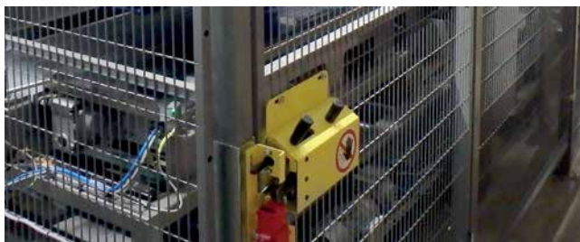
Dørlås på låge til maskinanlæg.
