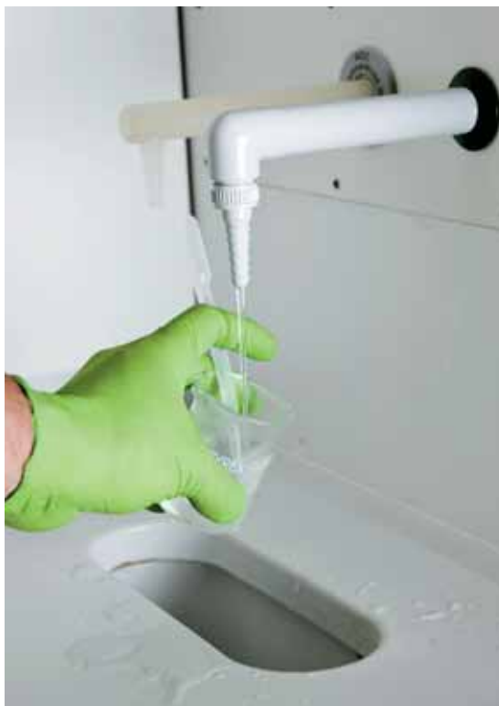
Aftapning af vand over vask i bordplade.
