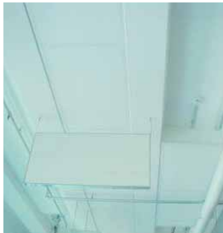
Lukket akustikloft med underhængende lodret akustikplade og fugning omkring rørgennemføringer.
