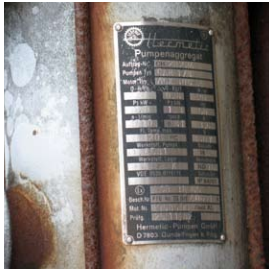
Detail fra pumpe motor (EX-mærkning af ældre dato)
