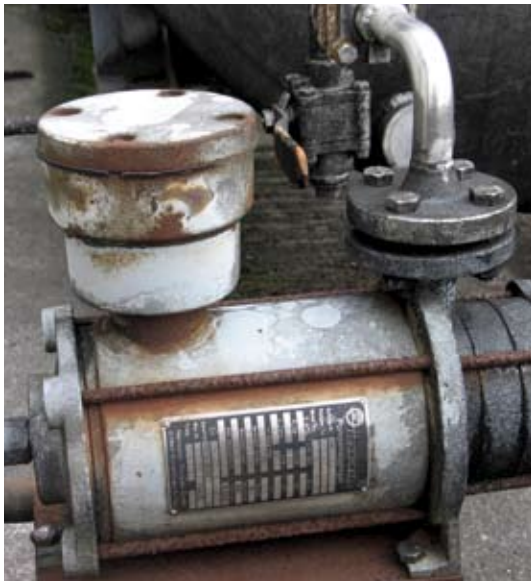
Ældre Ex-mærket udstyr (pumpe) til sprit.
