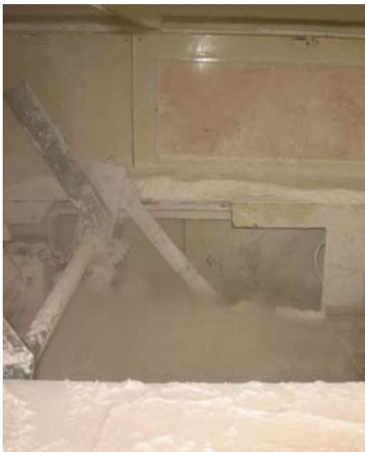
Anlæg til fremstilling af konfekturer anvender ofte majs mel som støbemateriale. Når bakker med majs mel tømmes, dannes der store mængder støv, og dele af det indre af anlægget vil derfor skulle zoneklassificeres.
