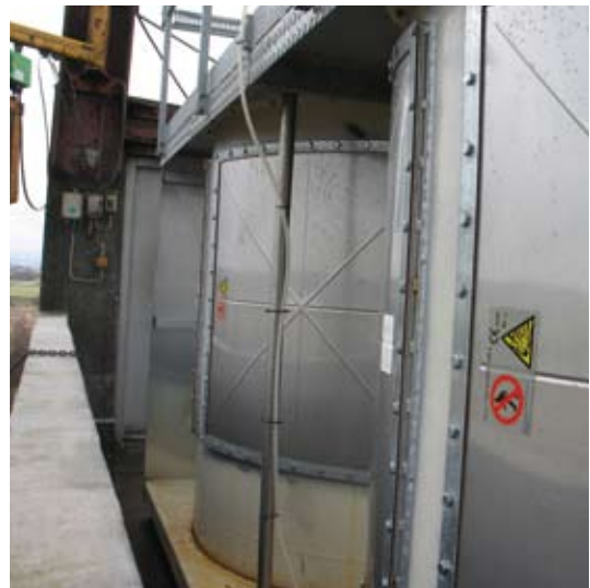
Eksplodingsaflastninger udendørs på toppen af nye siloer.
