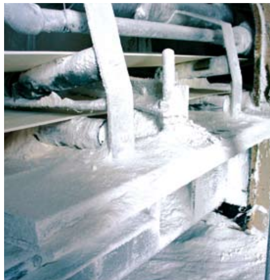
Rummet under sukkersiloen indeholder bl.a. transportbånd, så sukkeret kan transporteres ind i produktionen. Det indeholder også et posefilter, hvor overtrykluft fra påfyldning af siloen sendes igennem. Systemet er ikke tæt, og der slipper derfor store mængder støv ud under fyldning af siloen. Sukkerstøvet lægger sig på alle overflader i rummet og kan efterfølgende give anledning til eksplosiv atmosfære. Det indre af selve siloen skal med sikkerhed zoneklassificeres, men i det viste tilfælde skal også rummet under siloen zoneklassificeres.
