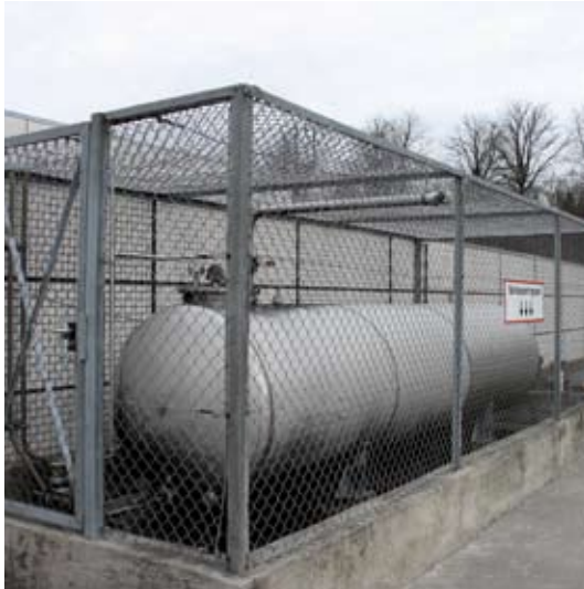
Oversigtsbillede af tankanlægget
