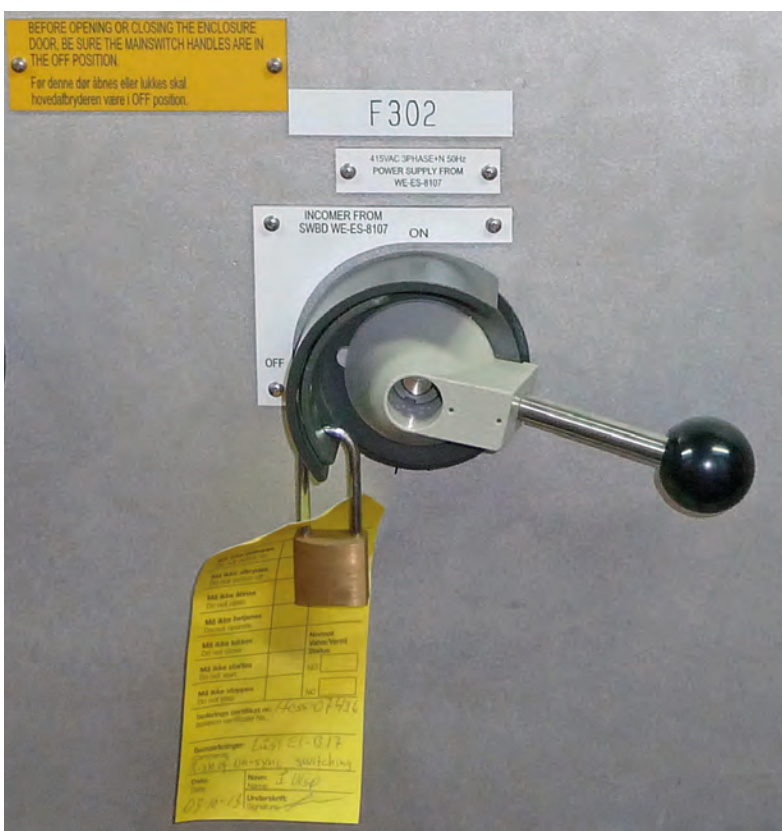
Sådan kan det gøres: Aflåselig forsyningsadskiller hvor den skal bruges, god skiltning og hængelåsen på plads. Låsen (Lock out) er suppleret med skiltning (Tag out), med mærkat med yderligere oplysninger. Foto: Maskinsikkerhed
