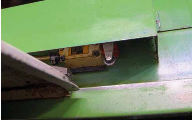
Typisk ældre sikkerhedsafbryder på skydelågen.
