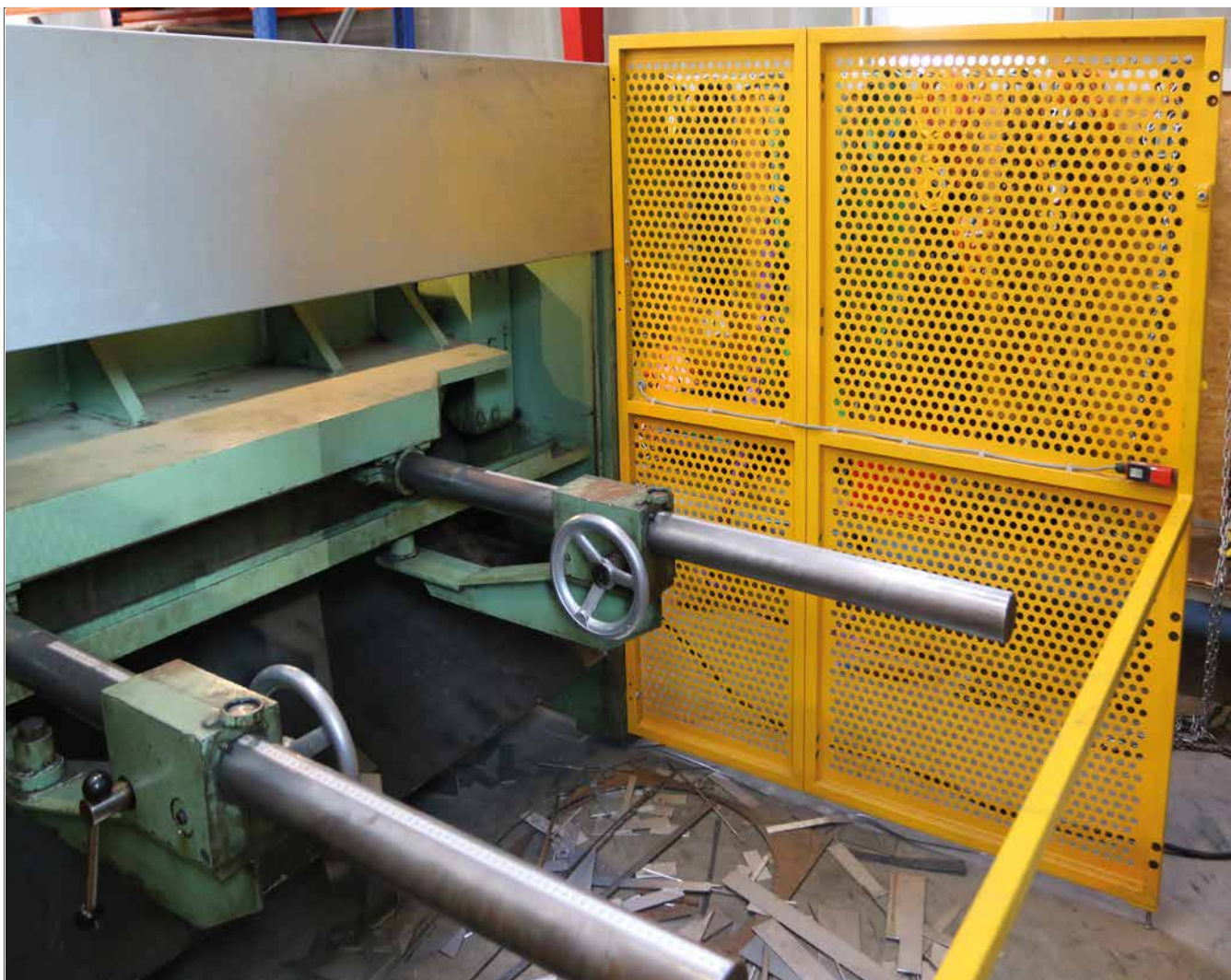
Sikringsgitter med overvåget bom bag pladesaksen.
