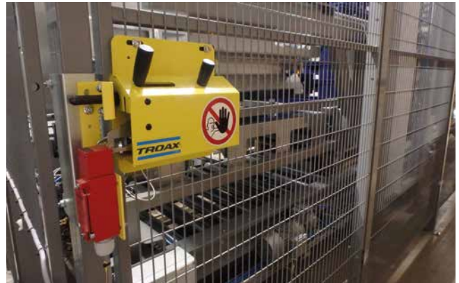
Dørlås, som først kan åbnes, når palleteringsanlægget er standset.
