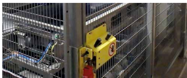
Dørlås på låge til maskinanlæg.
